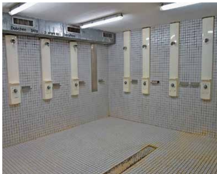
Heute teilen sich alle Altersklassen eine Dusche, die mit gesundheitsschädigendem Schimmel befallen ist.
