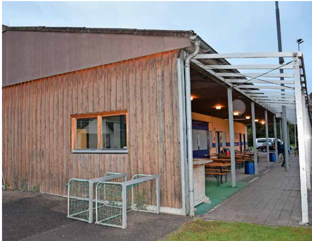
Das Sporthaus Stockwiesen in Thayngen ist mit seinen bald 60 Jahren in die Jahre gekommen. Auch Asbest findet sich hier.
