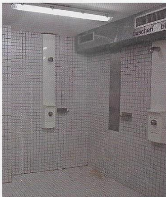
Ein Duschraum für alle – und das ohne funktionierende Lüftung.
